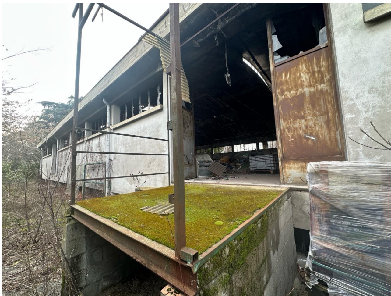
Ingresso laterale Capannone, lo stato danneggiato e di abbandono, l'interno ingombro con materiali vari.
