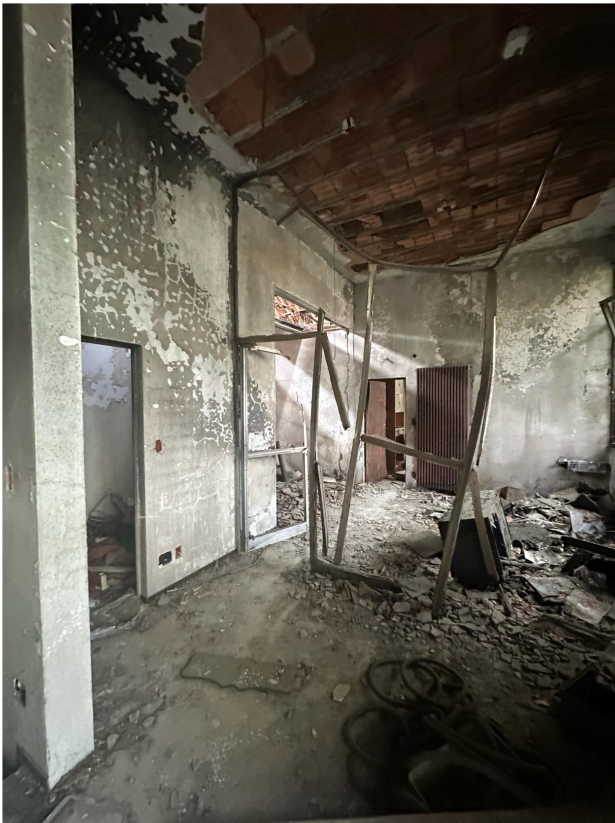
Interno piano terreno del capannone: lo stato danneggiato e di abbandono ingombro con materiali vari.
