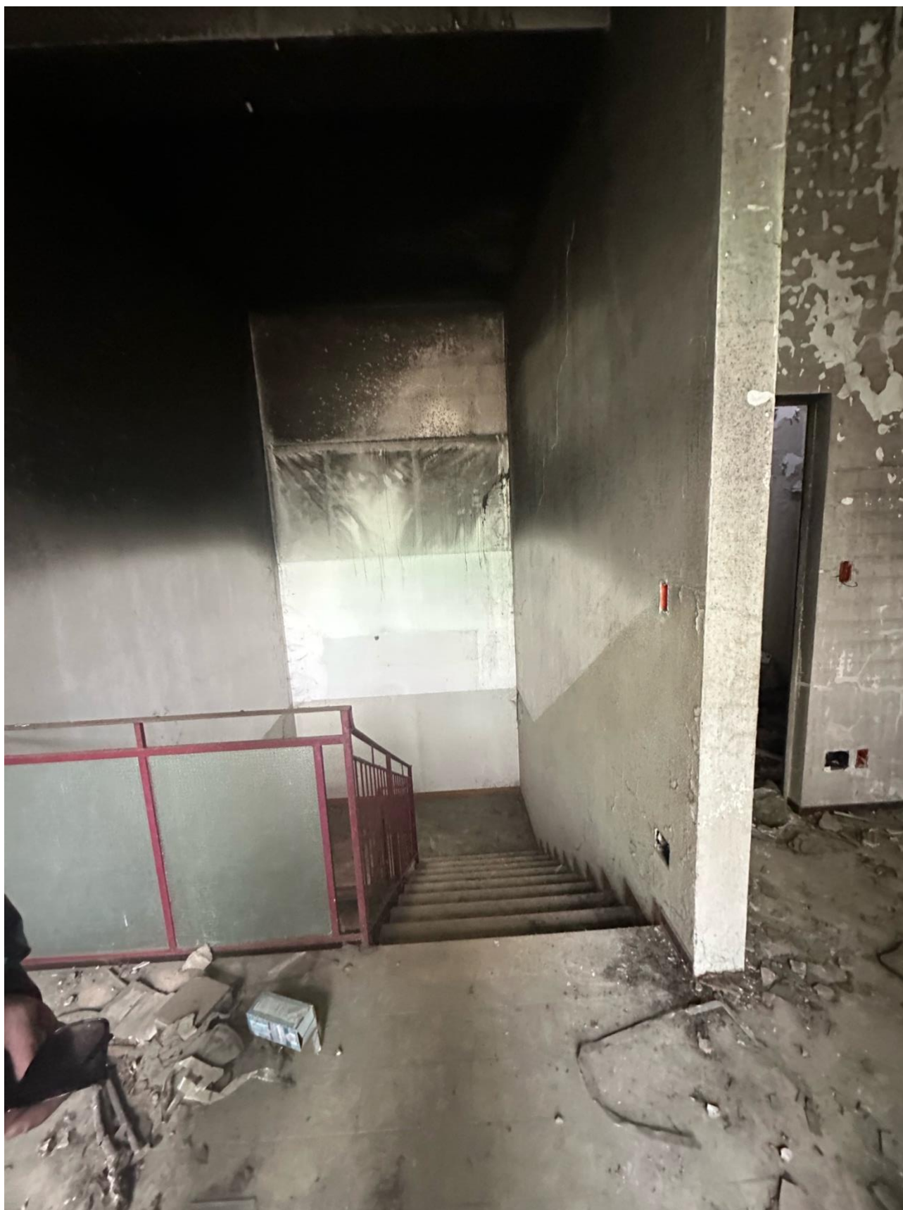
Interno piano terreno del capannone, la scala di accesso al piano interrato: lo stato danneggiato e di abbandono ingombro con materiali vari.
