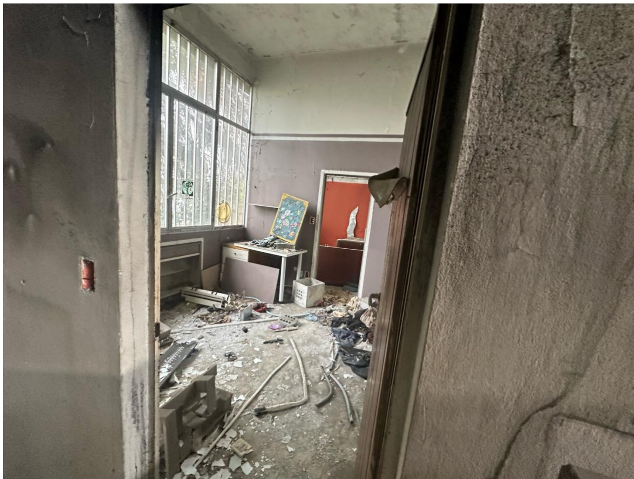
Interno piano terreno del capannone (zona uffici): lo stato danneggiato e di abbandono ingombro con materiali vari.
