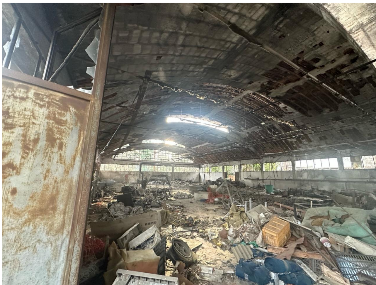
Interno piano terreno del capannone lo stato danneggiato e di abbandono ingombro con materiali vari.
